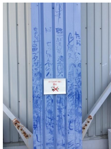
写真5.チョーキングした外壁
